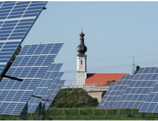
Abb. 41: Freiflächen-Photovoltaikanlagen können bei richtigen Bedingungen auch parallel zu einer weiteren landwirtschaftlichen Nutzung der Flächen betrieben werden.
